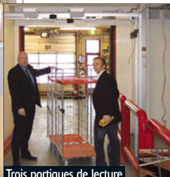
Trois portiques de lecture longue distance de tags RFID ont été installés dans la région d'Helsinki. 200 portiques seront installés dans les deux années à venir.
